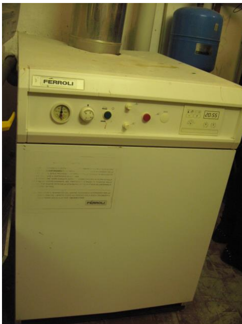
Figura 4.12 – Particolare del generatore di calore a basemento
