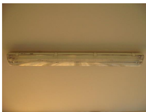
Figura 4.17 - Particolare dei corpi illuminanti ubicati nelle aule
