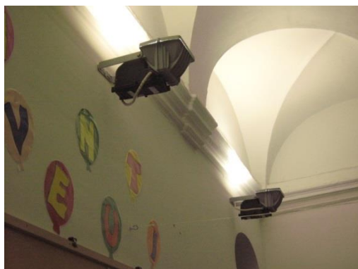
Figura 4.16 - Particolare dei corpi illuminanti ubicati nel corridoio
